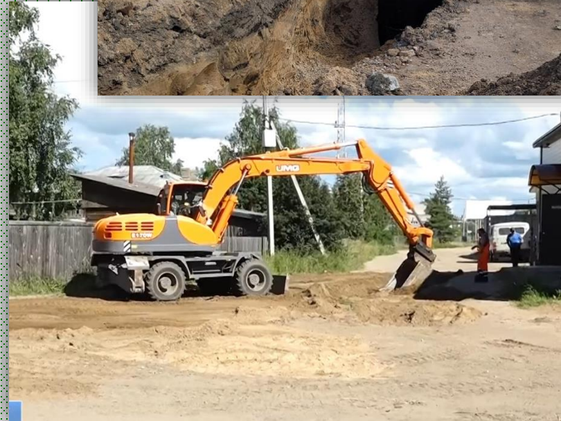
Устройство участка ливневой канализации в районе магазина по ул. Гледенская, д.75в, г. Великий Устюг
