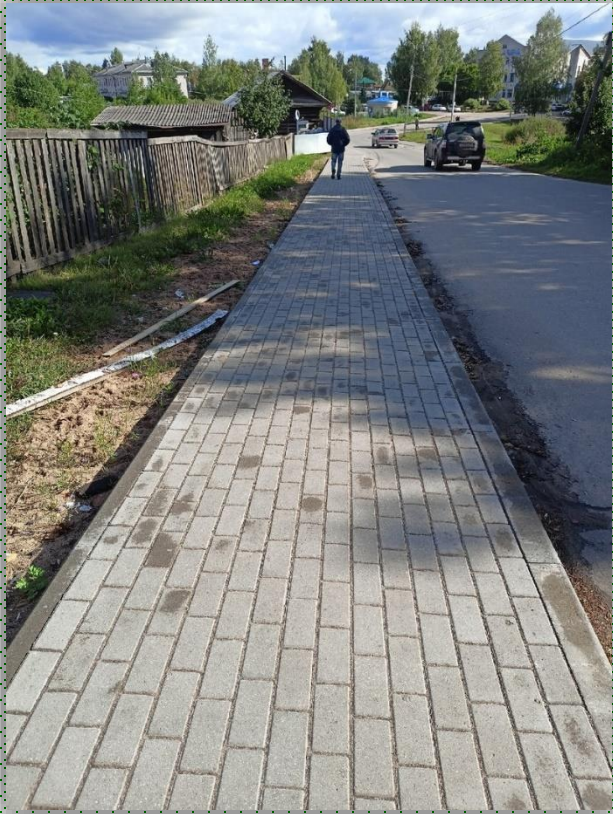
Обустройство тротуара по ул. Катышево (от ул. Павла Покровского до ул. Копылова) в г. Великий Устюг
